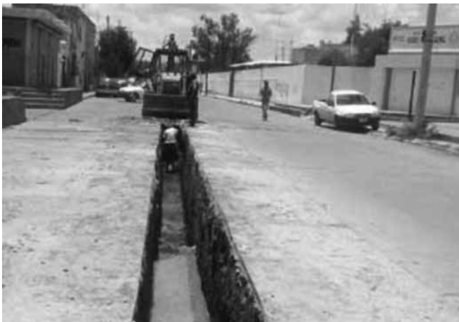
Figura 1.7 Descoordinación intragubernamental: se realizan obras hidráulicas después de la pavimentación de calles
